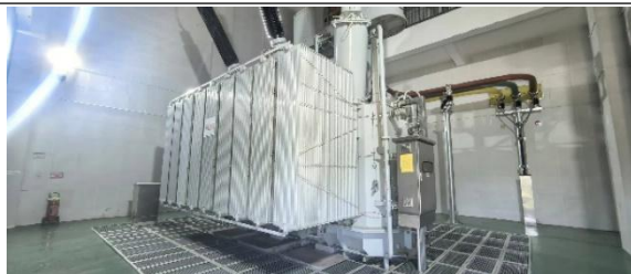
#5 主变及下方事故油坑
