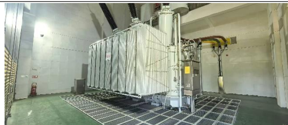
#6 主变及下方事故油坑
