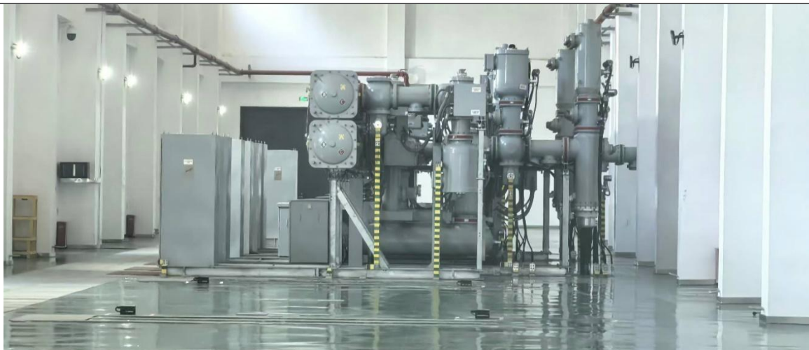
220kV GIS 设备
